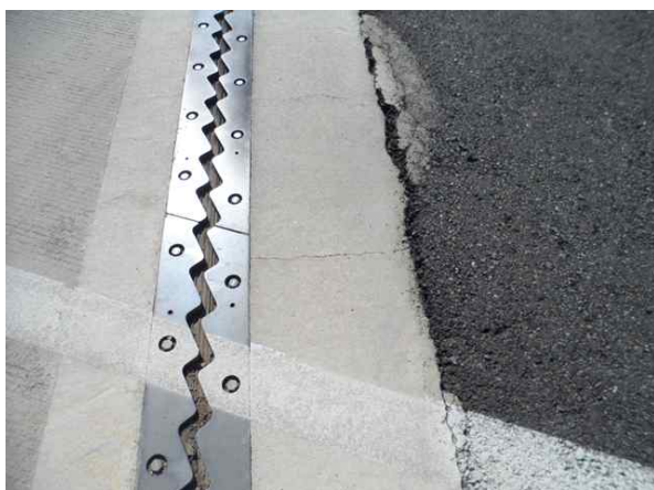
A2 후타재 균열(Cw=0.3mm미만)-문산방향
