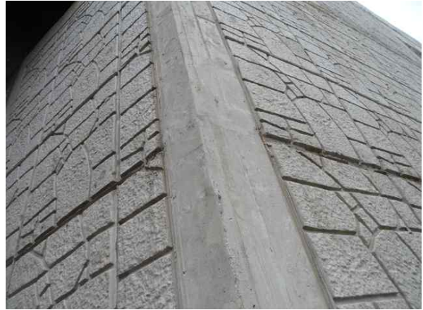
A1 보수부 재균열(Cw=0.3mm미만)-서울방향
