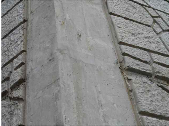
A1 보수부 재균열(Cw=0.3mm미만)-서울방향
