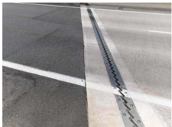
A2 후타재 균열(Cw=0.3mm미만)-서울방향
