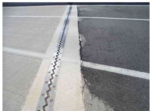
A2 후타재 균열(Cw=0.3mm미만)-문산방향
